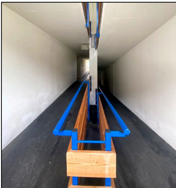
Abb.12: Notrampe zur Entfluchtung (Rampe hat höheres Gefälle )
