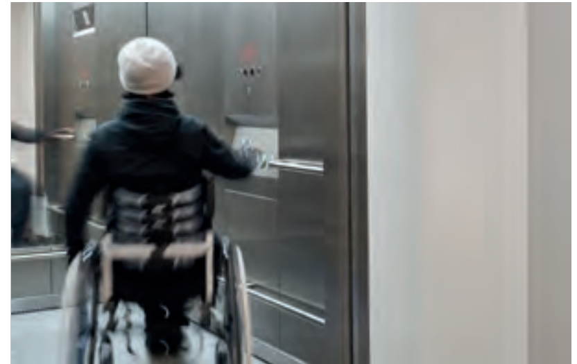
Barrierefreies Aufzugstableau, Sportpark Freiam, München
