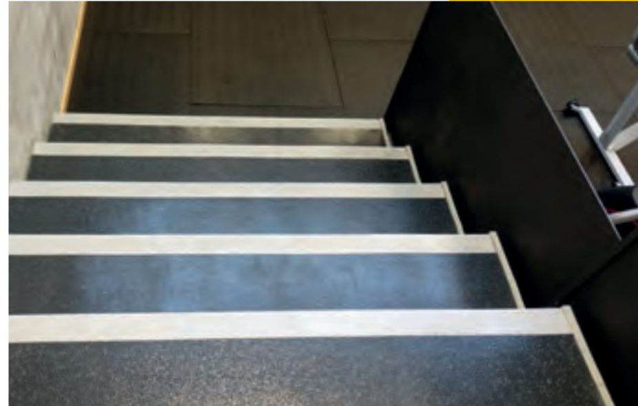
Stufenmarkierung, Edith-Stein-Realschule, Sehbehinderten- und Blindenzentrum Südbayern, Unterschleißheim
