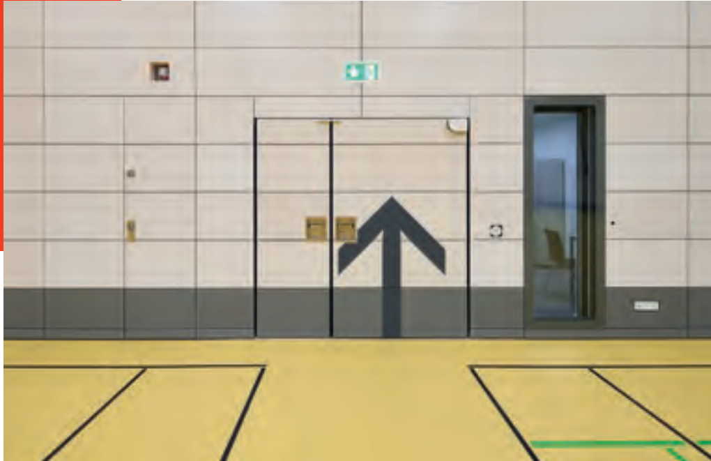
Kontrast zwischen Boden und Wand mit Kennzeichnung der Türen, Sportpark Freiam, München
